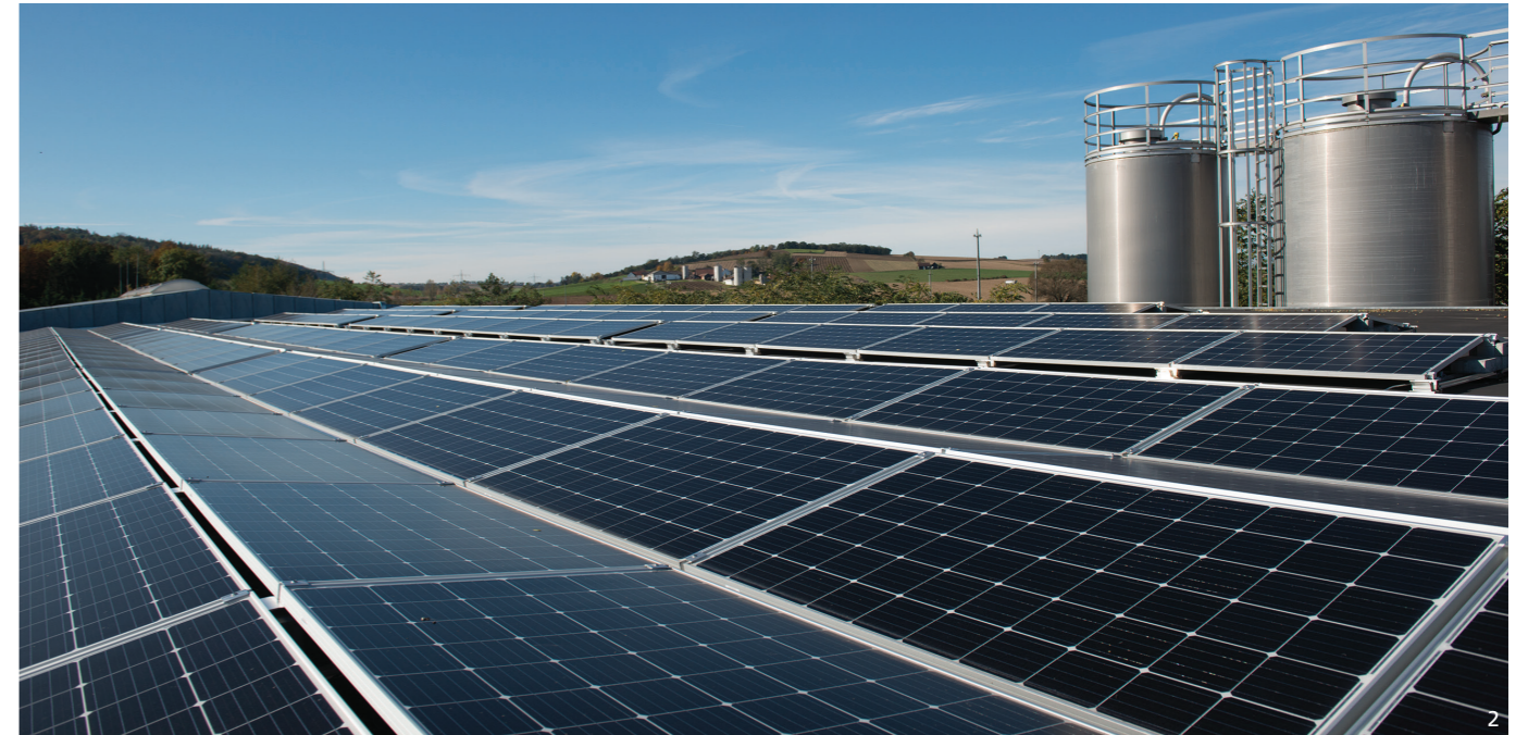
Ein Solarkraftwerk am Dach der MIRAPLAST-Zentrale in Würmla erzeugt ca. 30 Prozent des jährlichen Stromverbrauches.
